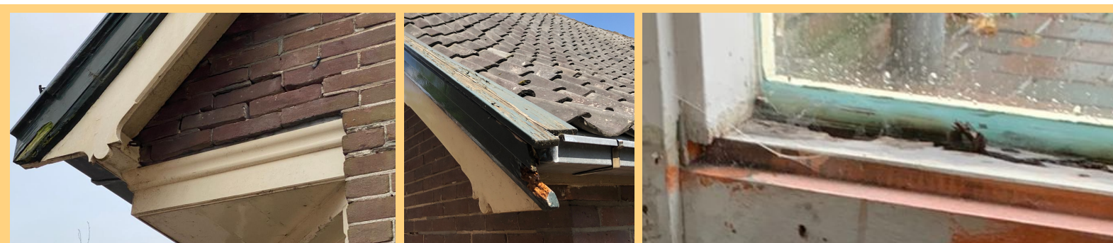
Dit zijn slechts enkele foto's die laten zien dat herstel van o.a. voegwerk, windveren, kozijnen.
