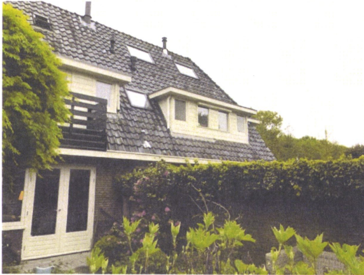
Achterzijde van de woning (links Ericaweg nr 11; rechts Ericaweg nr. 9) met huidige scheidsmuur.
