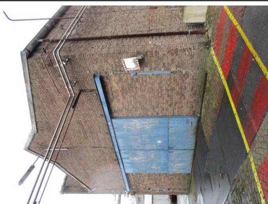
18. Volledig verweerd schilderwerk op boeiden (gebouw 4 zuidzijde)
