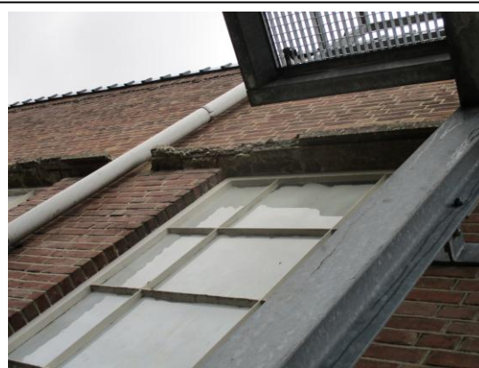
08. Beschadigde betonnen lekdorpel (gebouw 10 oostzijde)
