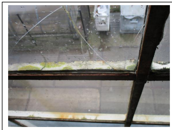
06. Roestende stalen vensters (gebouw 2 westzijde)
