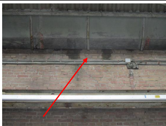
15. Lekkende zakgoot achter doorgemetselde langsgewel (gebouw 4 westzijde)
