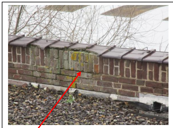
05. Beschadigde keramische muurafdekkers (gebouw 10B westzijde)
