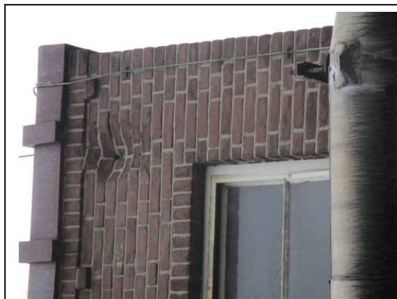
02. Mechanische beschadiging (gebouw 25 oost- zijde)
