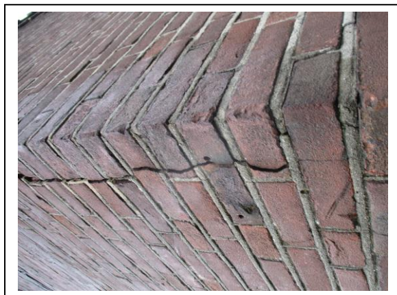
01. Beschadigd en verschoven metselwerk (gebouw 2 zuidwestzijde)
