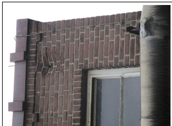
02. Mechanische beschadiging (gebouw 25 oostzijde)
