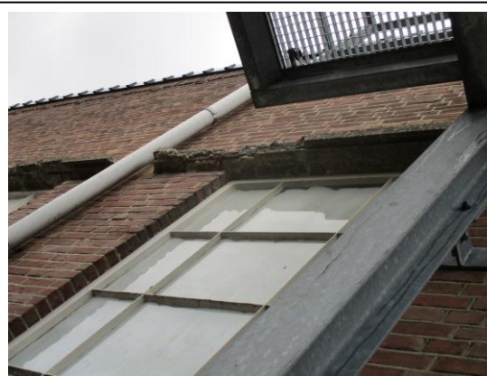
08. Beschadigde betonnen lekdorpel (gebouw 10 oostzijde)
