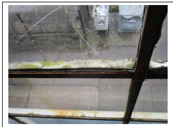
06. Roestende stalen vensters (gebouw 2 westzijde)
