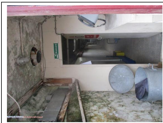
13. Lekkage en algvorming in de gang. (gebouw 2 gang oostzijde)
