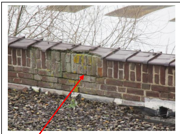
05. Beschadigde keramische muurafdekkers (gebouw 10B westzijde)
