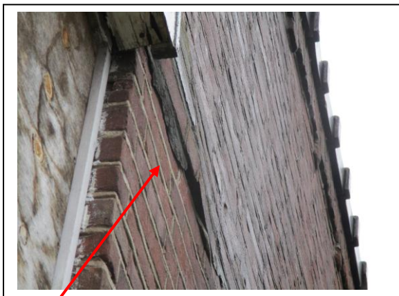
03. Het metselwerk is ernstig beschadigd door roestende stalen lateien (gebouw 2 westzijde)
