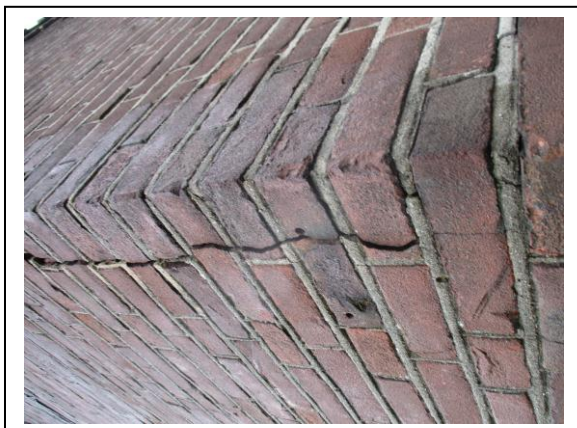
01. Beschadigd en verschoven metselwerk (gebouw 2 zuidwestzijde)
