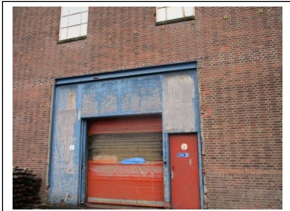
09. Industriële pui met slijtage en gebruikssporen. (gebouw 10B zuidzijde)
