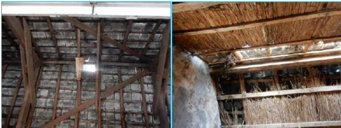
Foto's: Ontbreken dakbeschot schuur en ontbreken riet bij nok en gevels boerderij.
