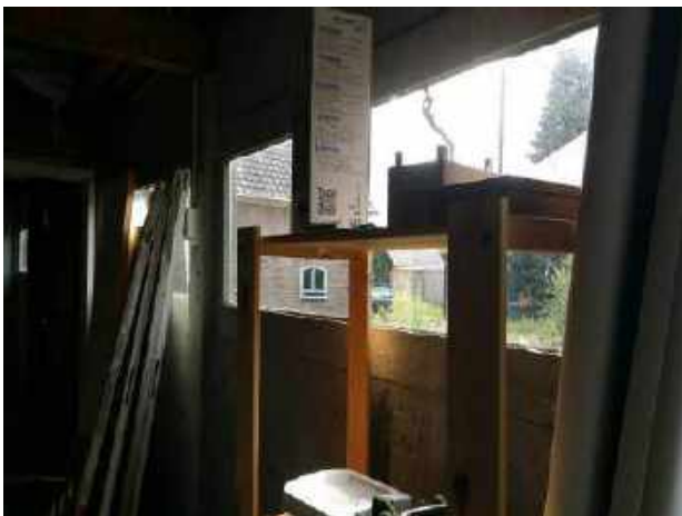
FB12: Tussen de kozijnen en de beglazing van dit deel van de garage is geen asbestverdachte kit waargenomen.
