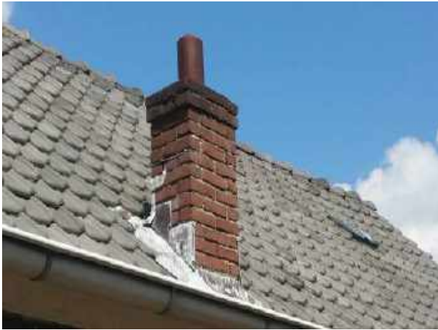
FB11: De rookgasafvoer op het gemetselde kanaal is van gres.
