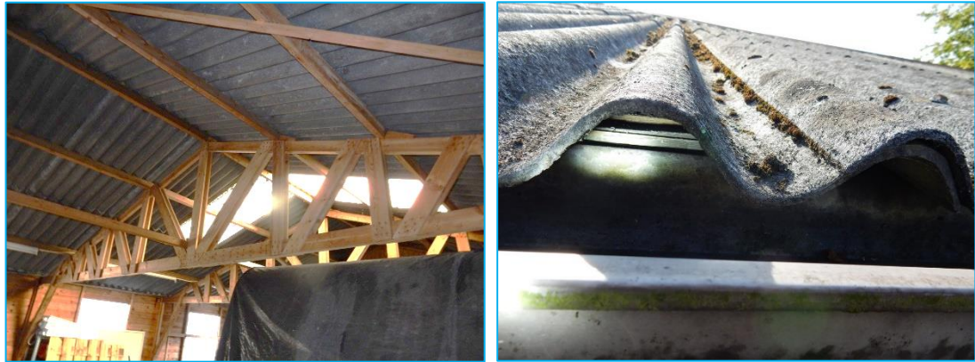
Foto's: Links; het ontbreken van isolatiemateriaal en/ of dakbeschot. Rechts; dakgoten gecontroleerd op nestsporen.
