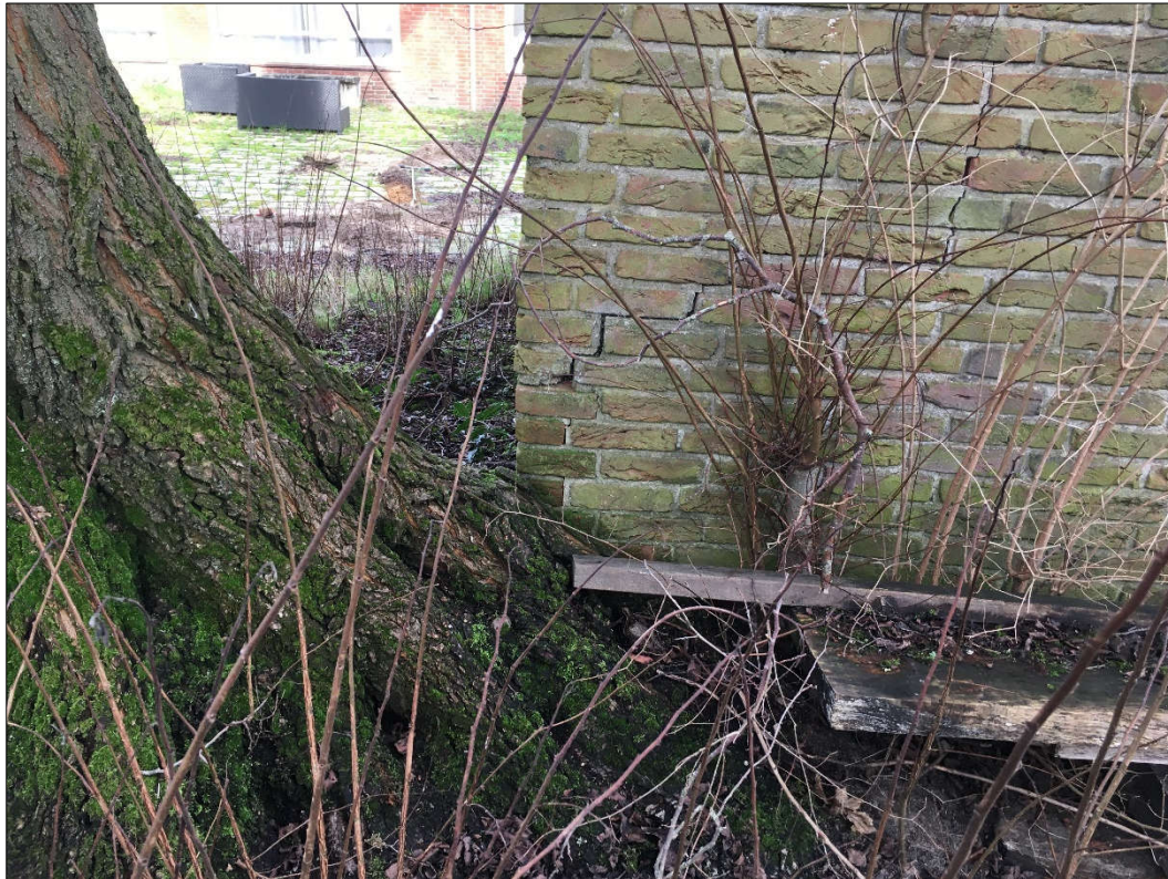
Afbeelding 12: Beworteling onder het bijgebouw;
