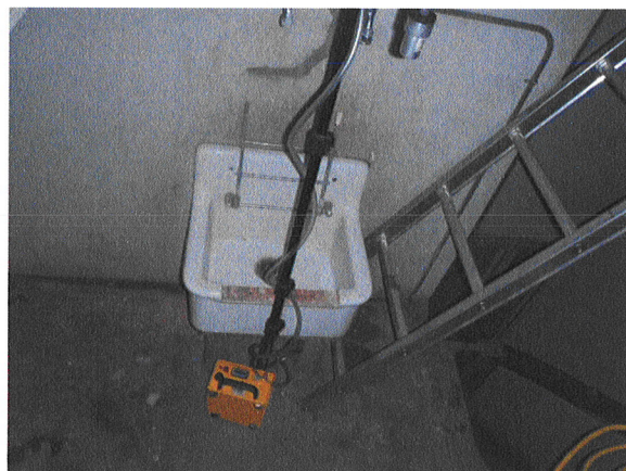
Toelichting bij foto 18: Pomp 3 staat op de begane grond.
