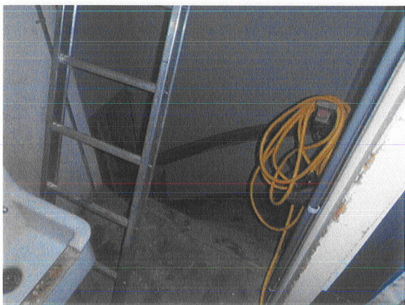
Toelichting bij foto 15: De toegang vanaf de begane grond naar de cv-ruimte.
