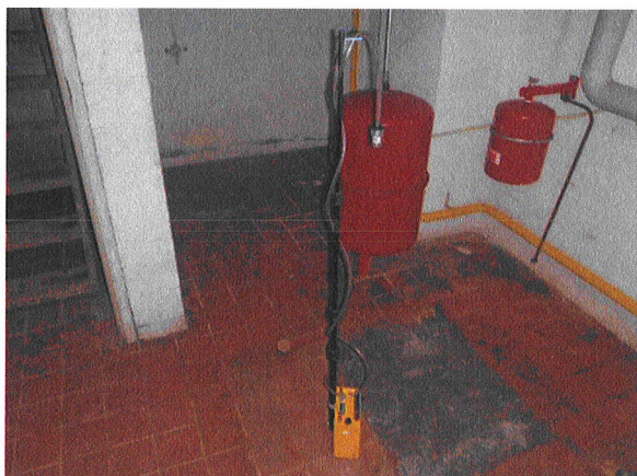
Toelichting bij foto 17: Pomp 2 staat in de cv-ruimte op de opstort.
