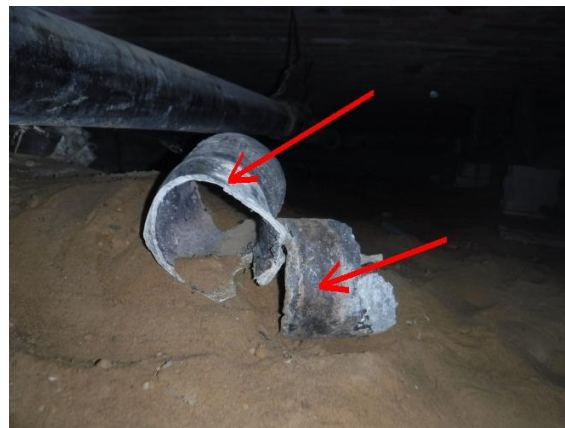
Restanten buis kruipruimte
