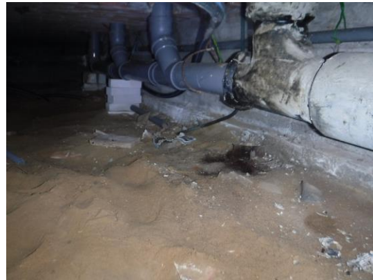
PVC-leidingen aangesloten op asbest buis
