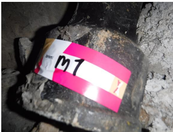
Restanten buis kruipruimte
