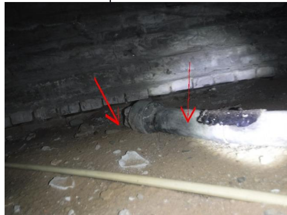
Restanten buis kruipruimte
