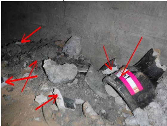
Restanten buis kruipruimte
