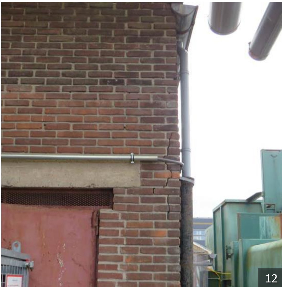
Scheuren metselwerk aan buitenzijde
