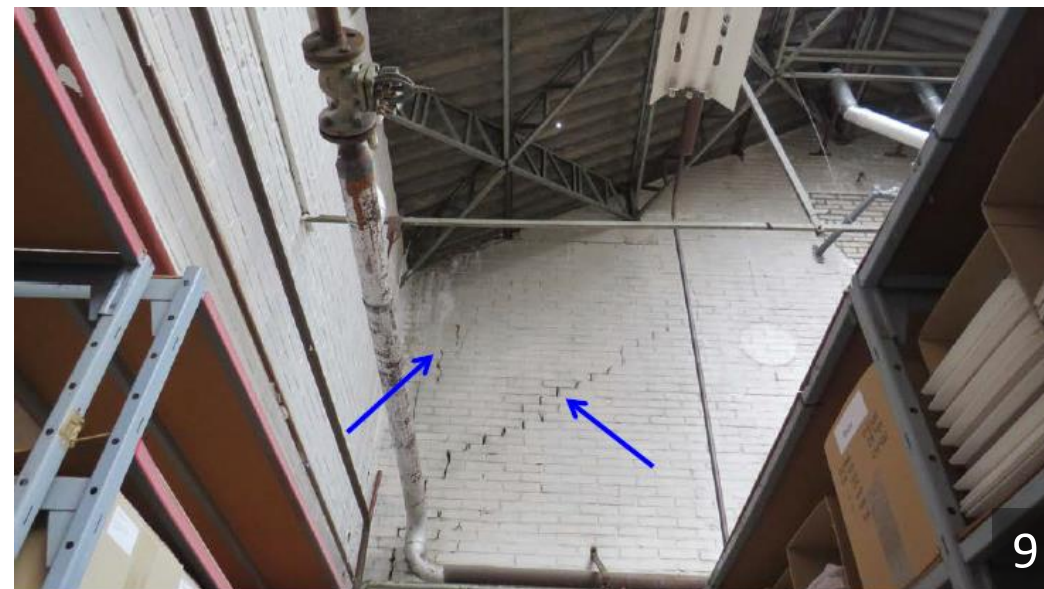
Scheuren in metselwerk kopgevel (1)
