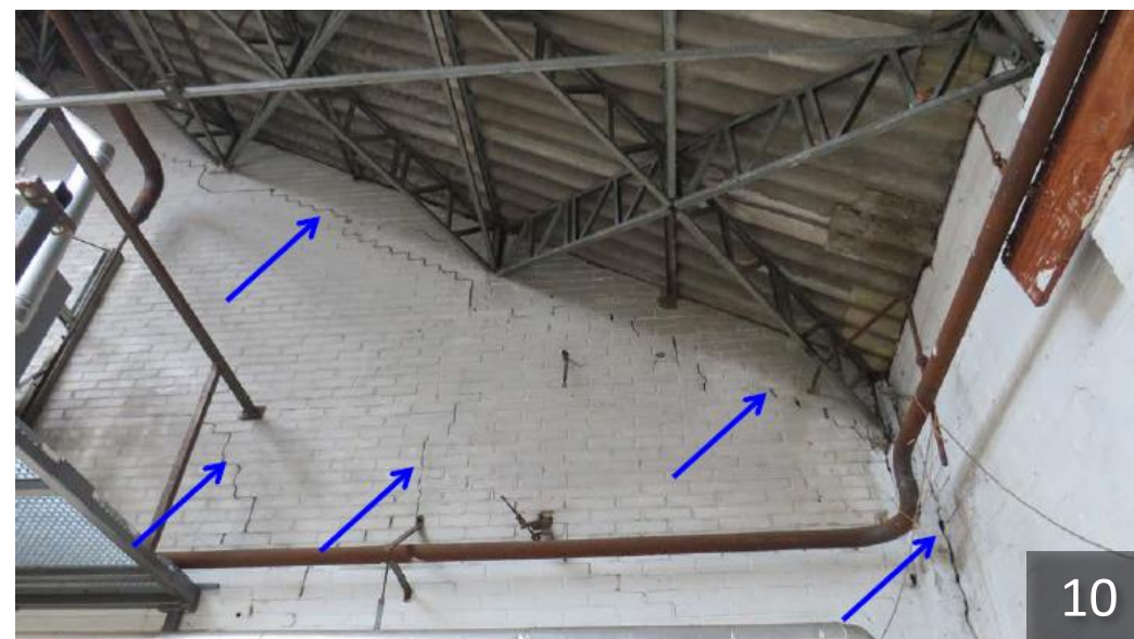
Scheuren in metselwerk kopgevel (2)
