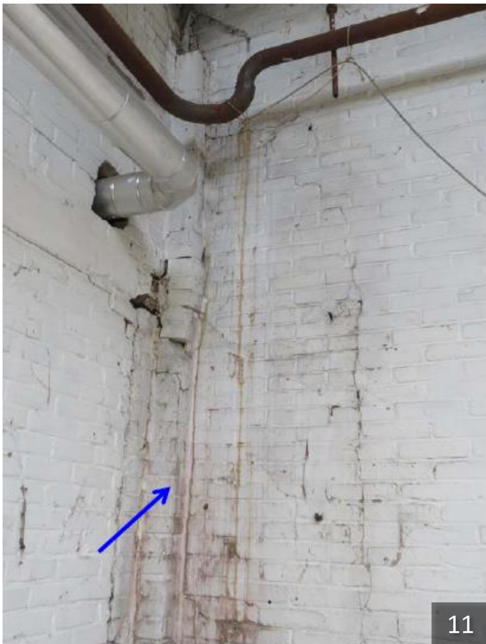
Lekkagesporen op het metselwerk
