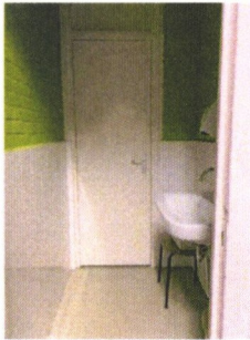
Toiletruimte in het Holleblok, voldoet niet aan Handboek Toegankelijkheid.
