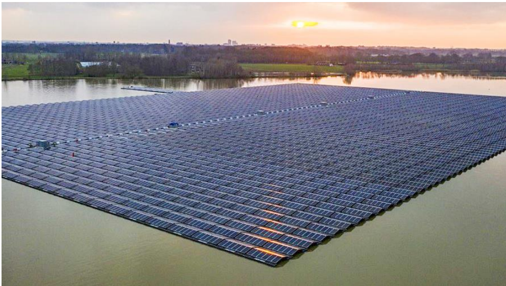
In een plas in de buurt van Zwolle liggen 72 duizend zonnepanelen. Foto: Energiefonds Overijssel
